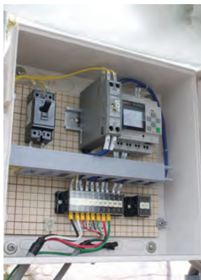
▲炭酸ガスの管理をする設備
